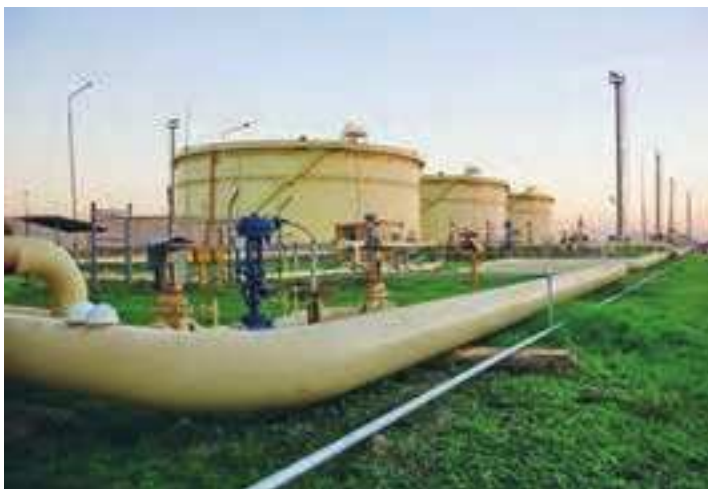
شکل ۲۱- نمایی از خطوط انتقال سوخت
